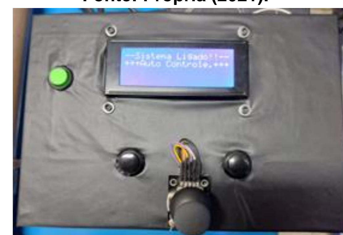
Figura 5 – Caixa de controle. Fonte: Própria (2022).
