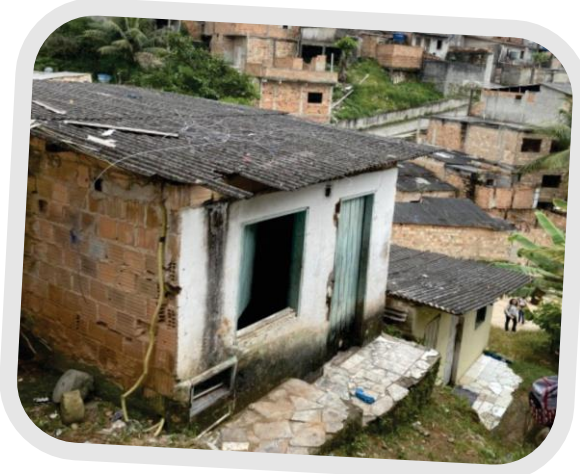
Figura 2 Habitações precárias no boqueirão visitado
